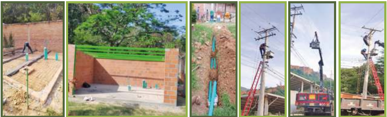
Fotos. Construcción de subestación eléctrica en el sector de la Fundación Semillas de Ilusión.
