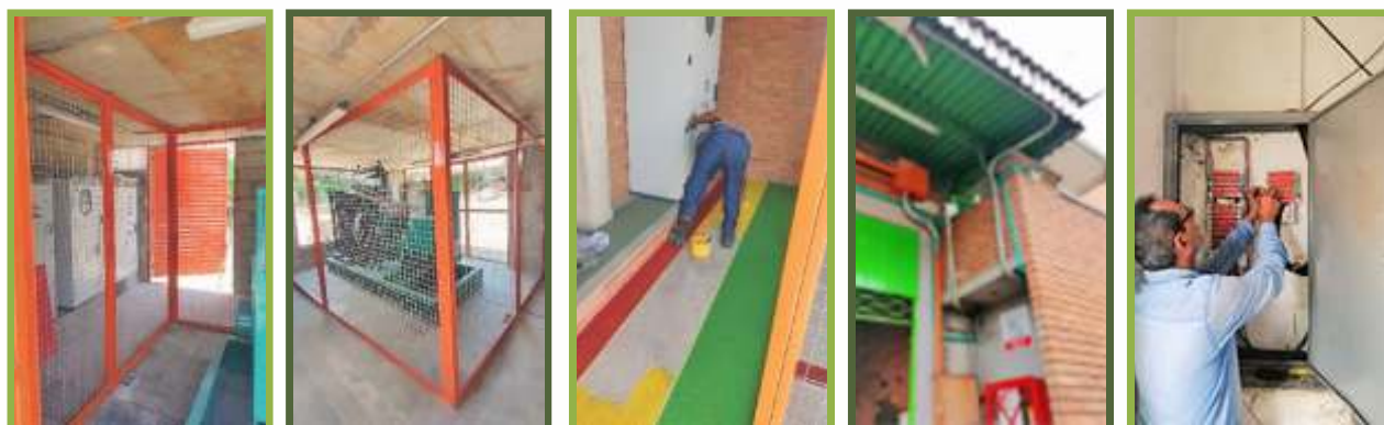
Fotos. Actividades para cumplimiento del RETIE en subestación del edificio Bicentenario y Administración; actividades de cambio de la red telefónica en la bodega No. 4 y No. 6 costado oriental.
