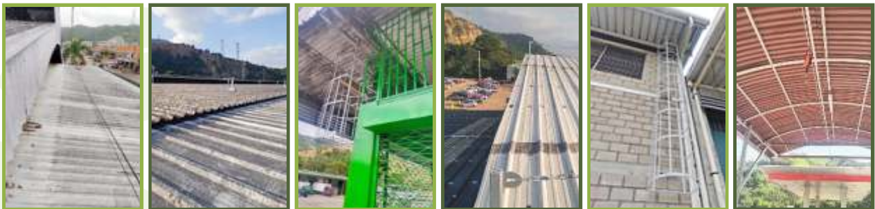
Fotos. Líneas de vida en el edificio administrativo, la bodega No. 9, bodega No. 7, bodega No. 13 y bodega No. 16 de Centroabastos.
