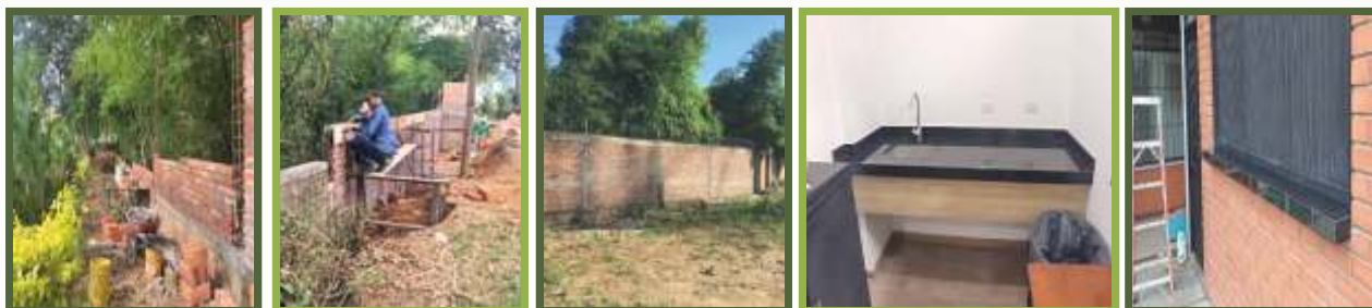
Fotos. Reparación de muro lindero costado occidental – frente a la báscula nueva y terminación de la nueva cafetería del auditorio de Centroabastos.
