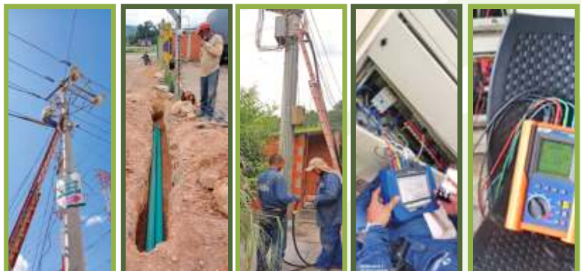
Fotos. Adecuación red de media tensión a 13.200 voltios en la EDS; mediciones con analizador de redes en diferentes subestaciones eléctricas
