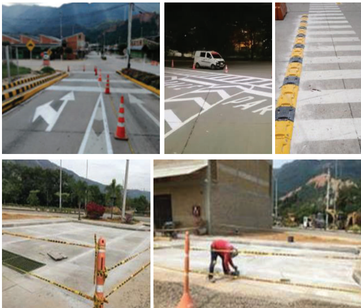
Imagen. Señalización vial, demarcación sobre vías para peatones, construcción de zona de parqueo en el costado norte de la bodega N.14, abril de 2020
