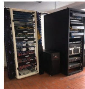
Imagen. Antes y después rack de sistemas, datos y comunicaciones
