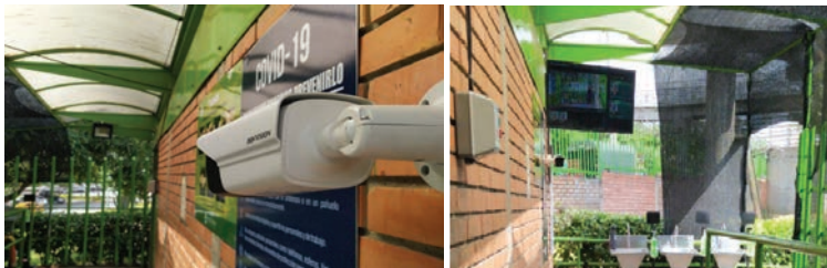
Instalación de cámaras de detección de temperatura y reconocimiento facial.
