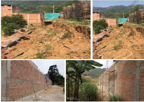
Imagen. Muro derribado por la acción de las aguas lluvias e inestabilidad del terreno, muro reconstruido.
