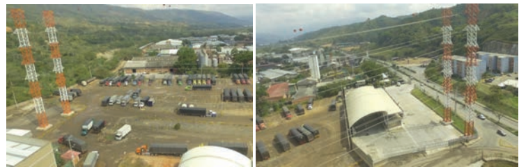
Imagen. Torres de transmisión red eléctrica a 230 KV. Diciembre de 2020
