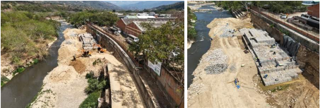
Fotos. Estado del muro de gaviones, averiado por las lluvias, antes de la intervención
